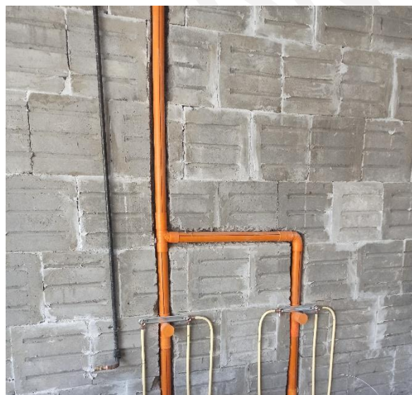
تصویر شماره 39 : درج تاسیسات در دیوار والاکس
